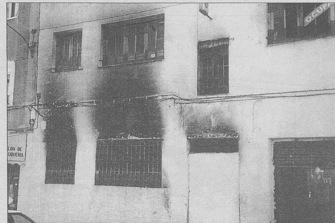
Estado en el que quedó la casa tras el incendio
