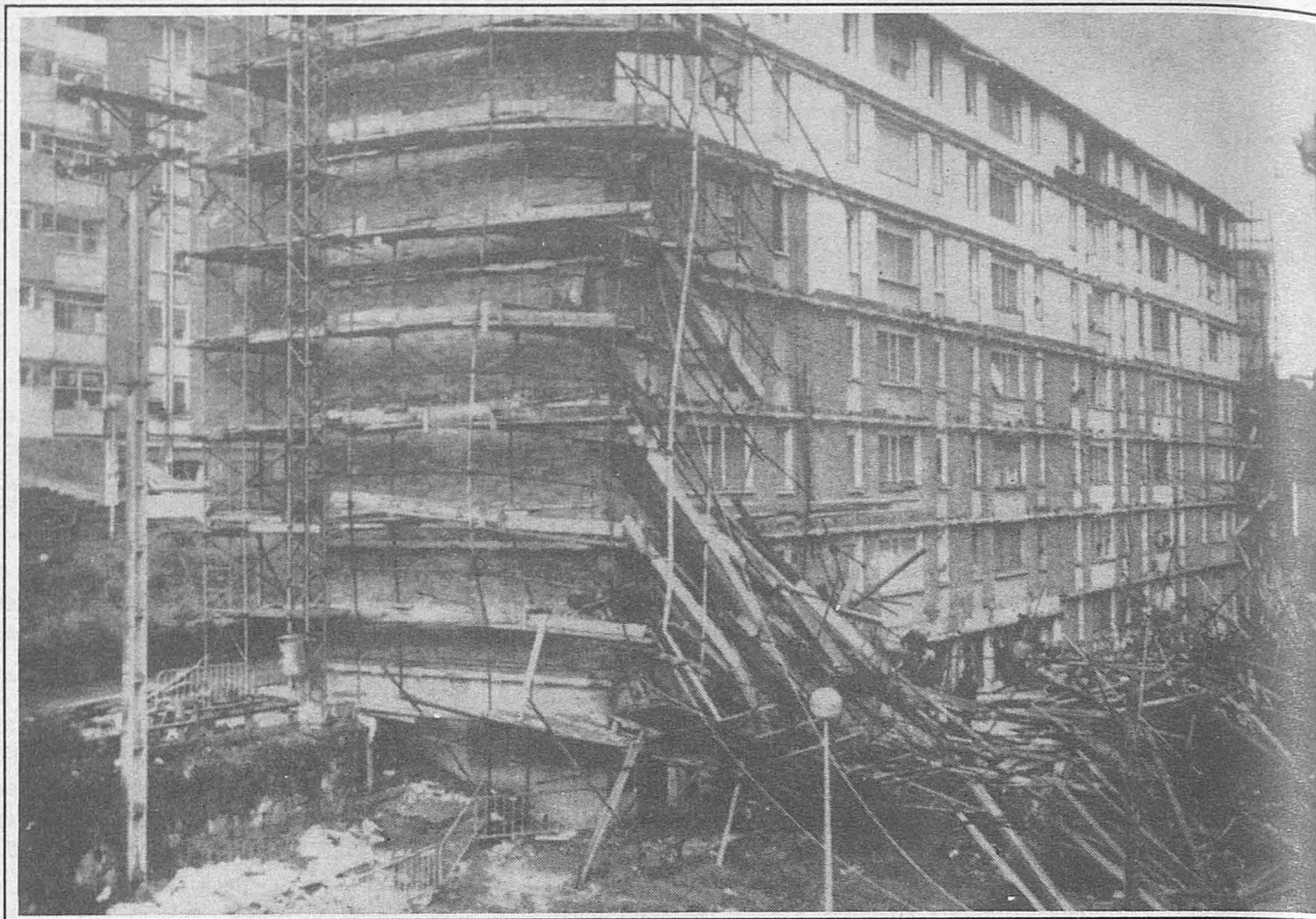
La Construcción es el sector con mayor índice de accidentes laborales
